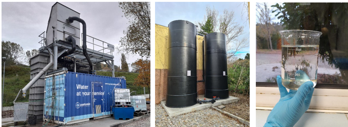
Figura 4 | Instalação piloto de produção de água para reutilização na ETAR do Freixo
